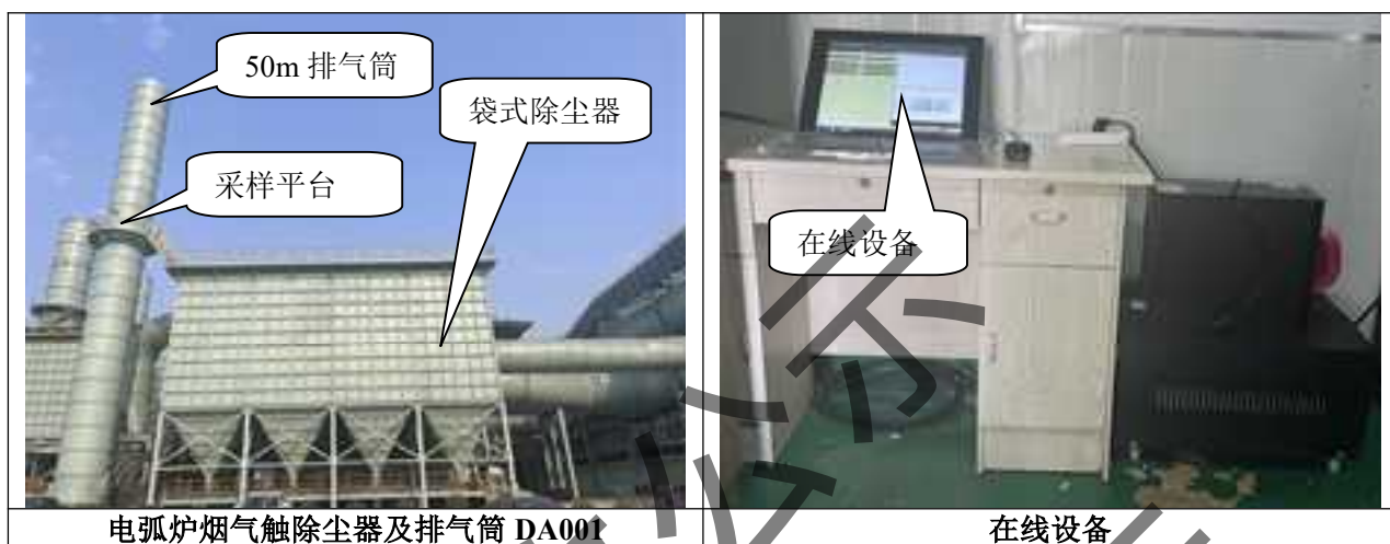
图 4.1-2 电弧炉废气处理措施
