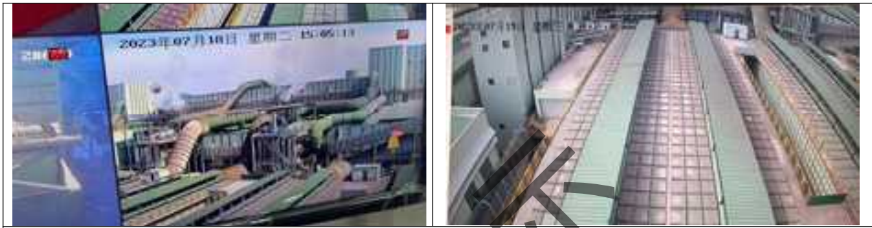
炼钢车间顶部设置监控
